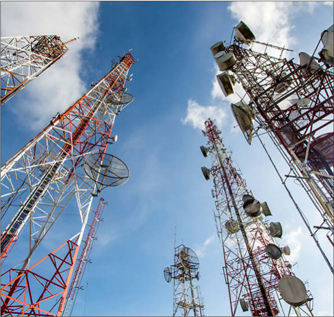
Antenas de telefonía y telecomunicaciones. ISTOCK
