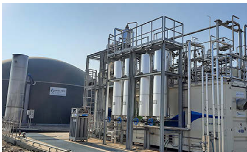
Instalaciones para la producción de biometano.
