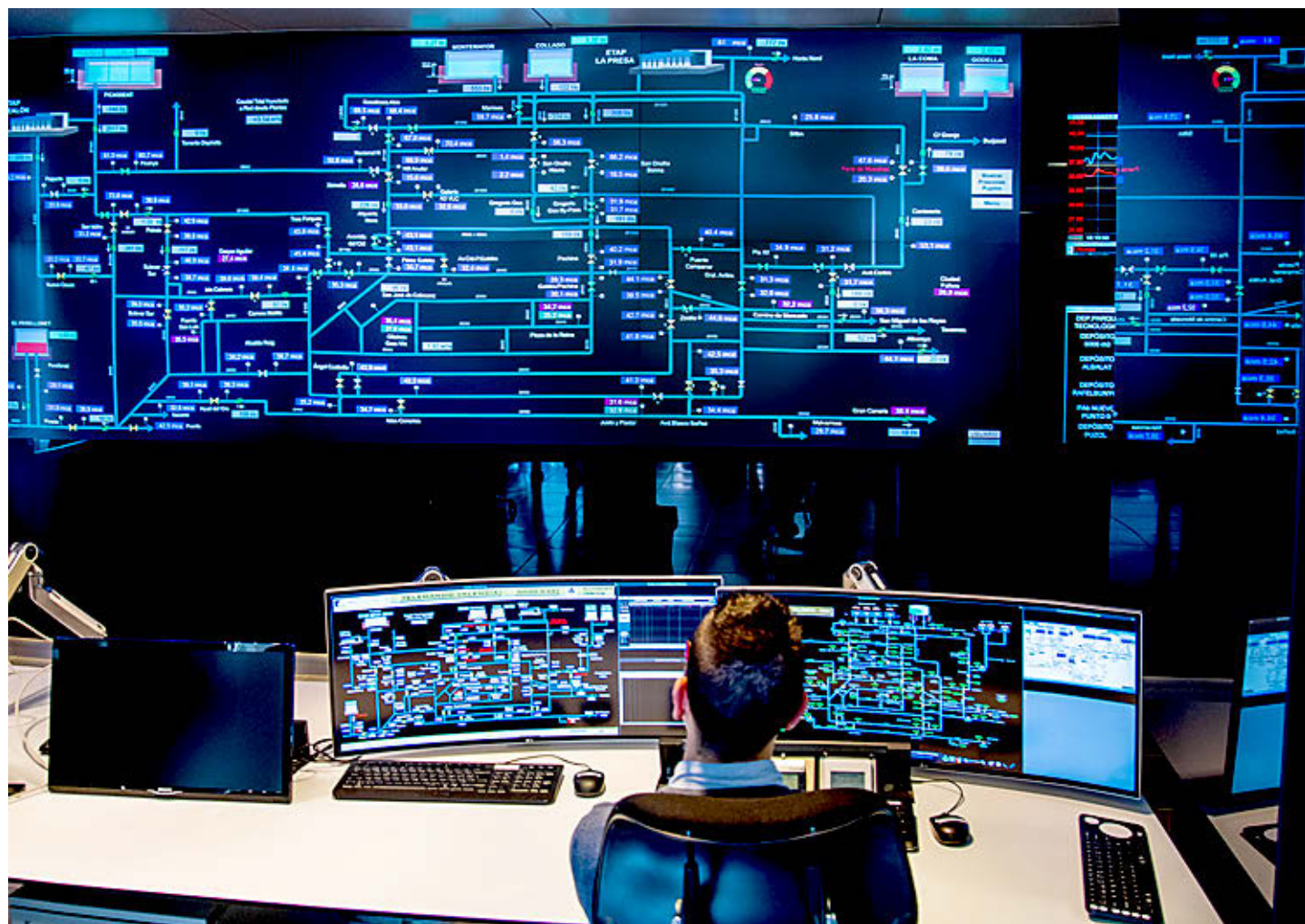
Sala de control de la red de abastecimiento de agua del área metropolitana de Valencia.
