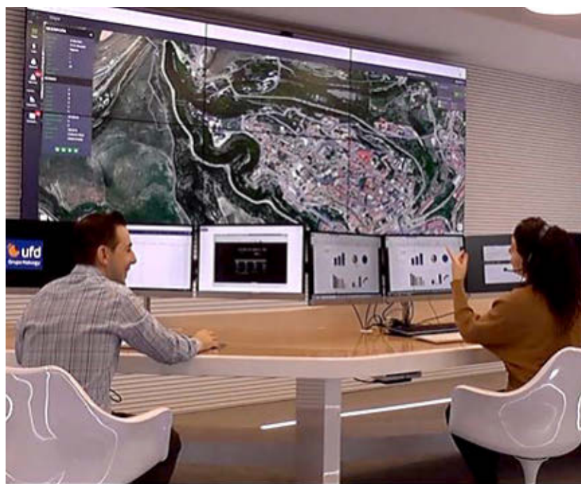
Centro de control de Naturgy. eE
