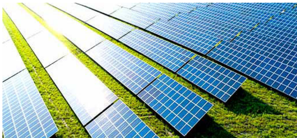
Planta solar fotovoltaica en Alemania. iStock
