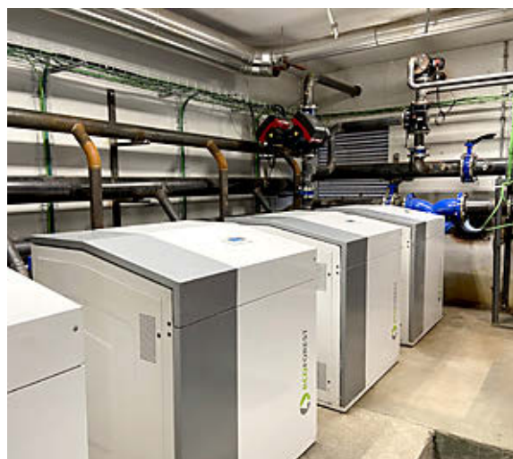
Bombas de calor instaladas.
