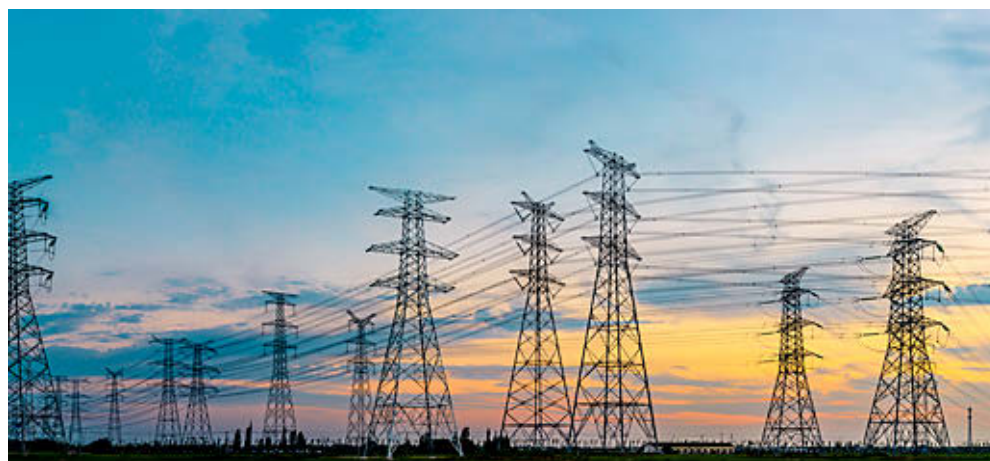
Torres eléctricas de alta tensión. iStock
