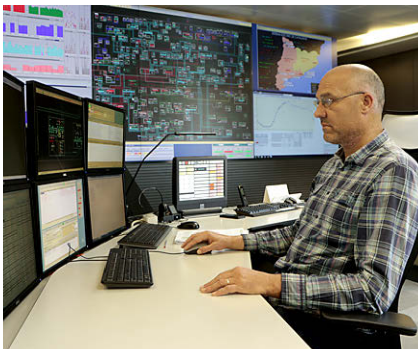
Centro de control de Endesa. eE
