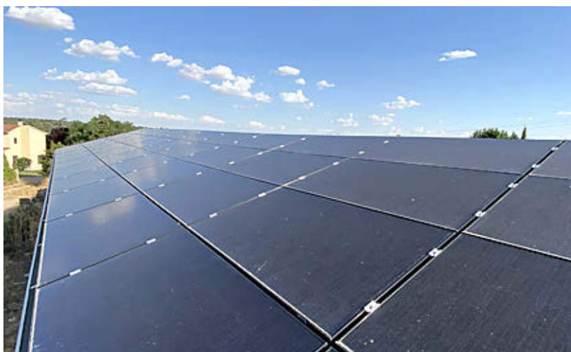
Paneles FV sobre la cubierta de una de las naves adyacentes al Castillo.
