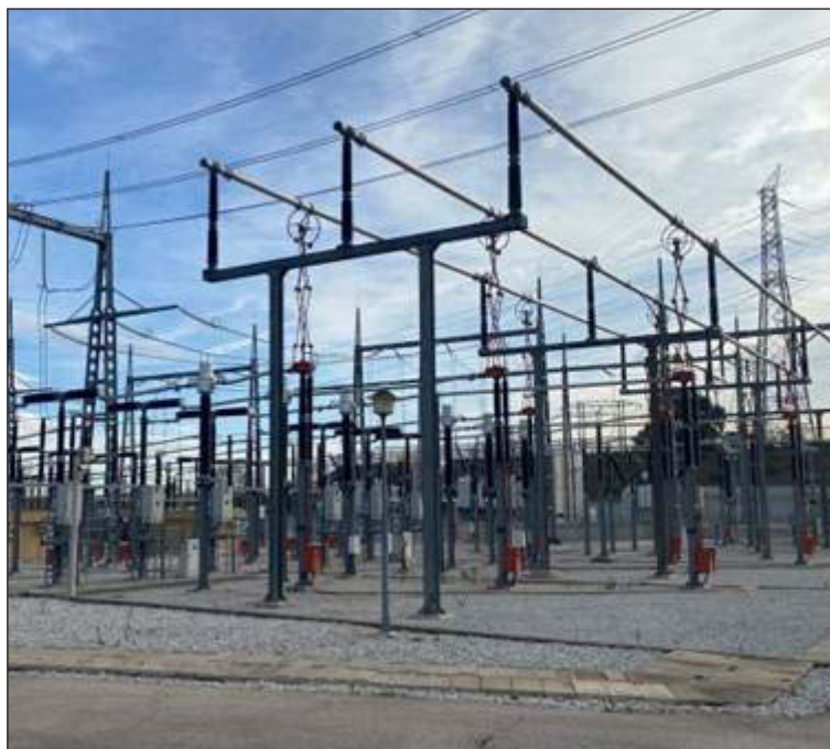
Subestación eléctrica de Redeia. EE
