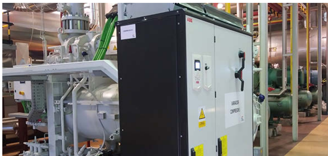
Algunos de los proyectos de eficiencia energética se han efectuado en las salas de frío SMFA y aire comprimido.
