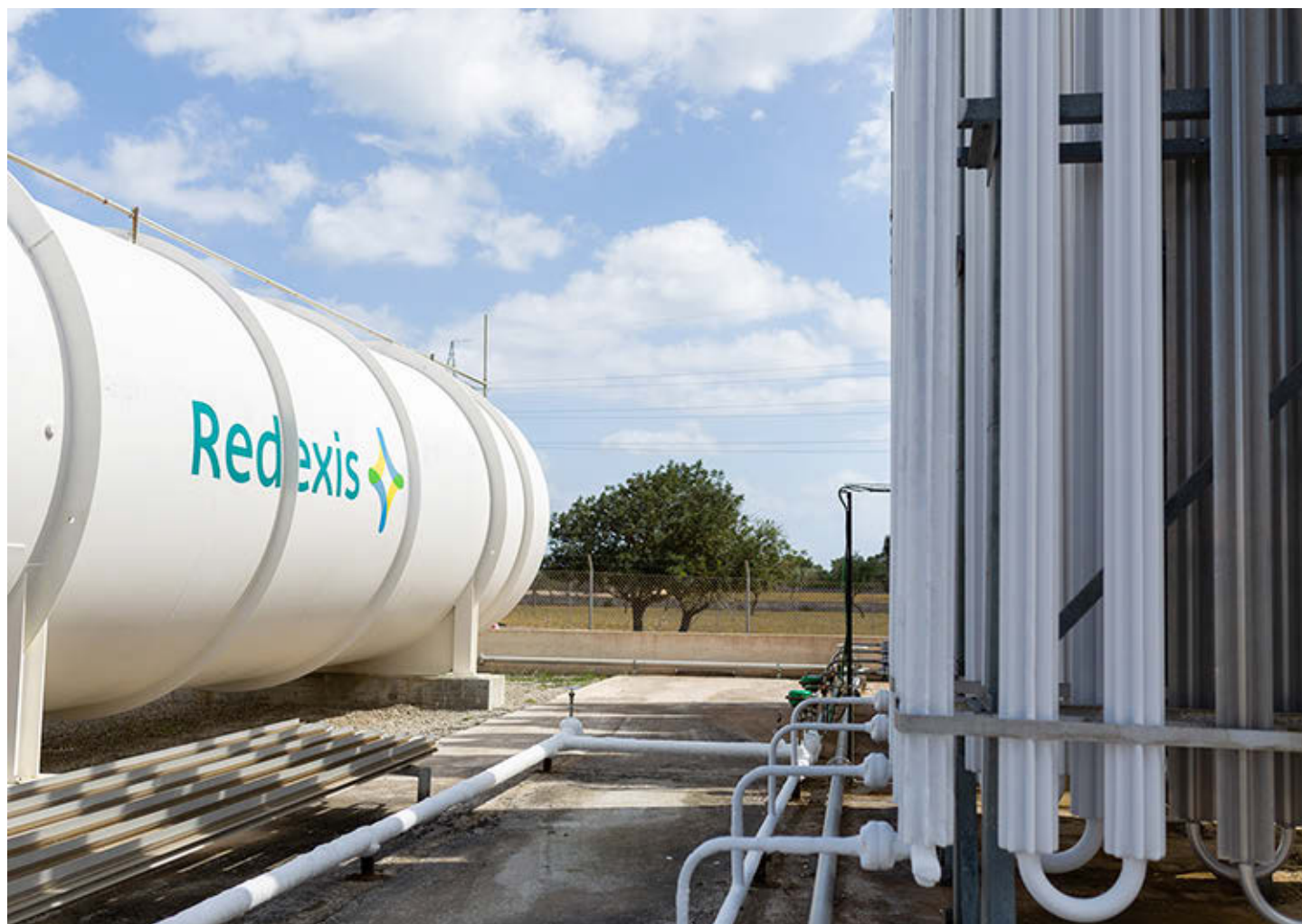
Planta de GNL. eE
