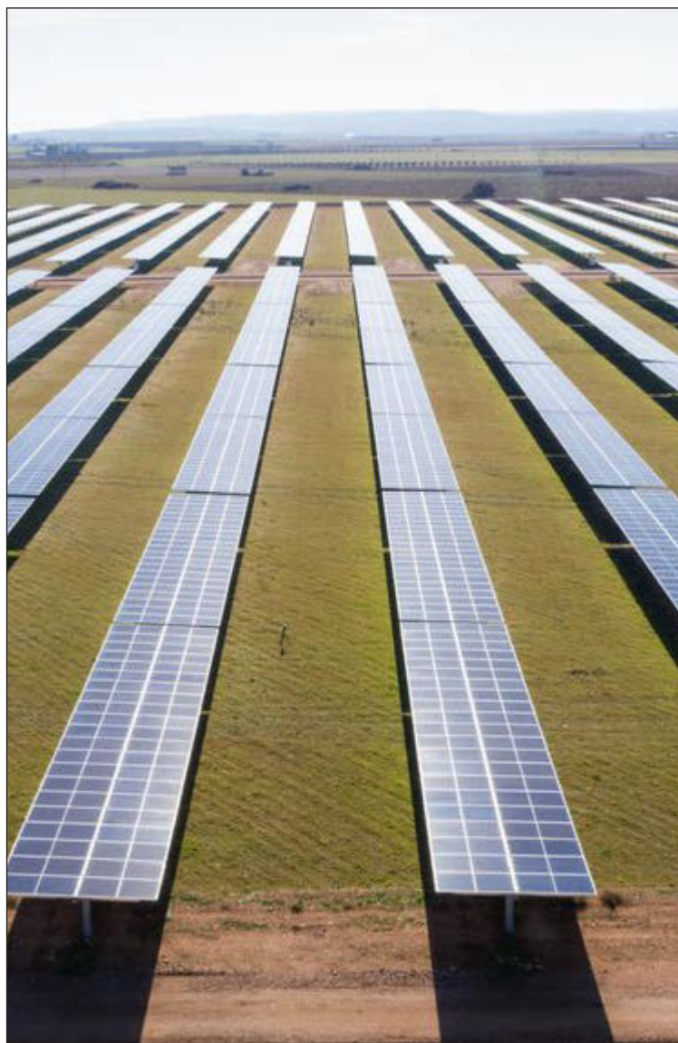
Una planta fotovoltaica EE
