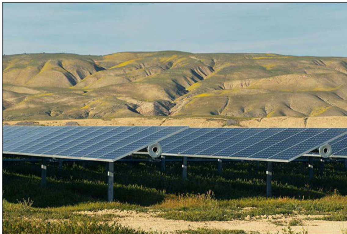
Instalación de energía solar. EE
